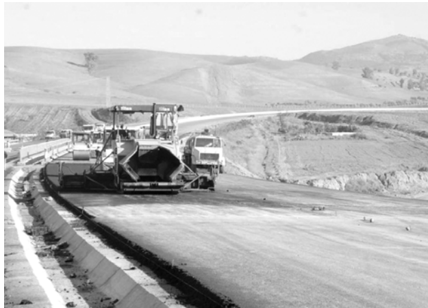
Le tracé traverse un relief montagneux nécessitant la réalisation de 37 ouvrages d'art
